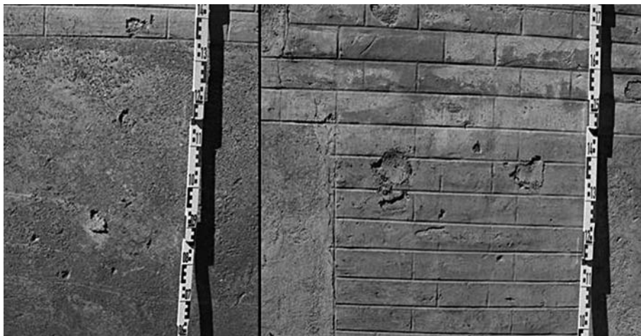
Fot.21. Impactos de bala recientemente cubiertos con cemento.
